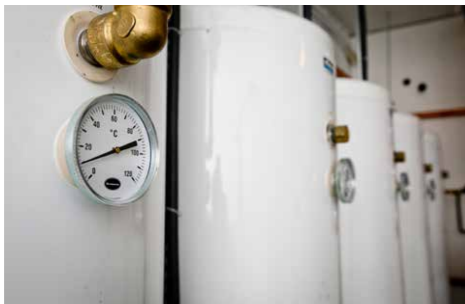
▲ NY: Det oppvarmede vannet fra fjellet kommer inn til berederrommet og fordeles via varmepumpe teknologi til leilighetene.
