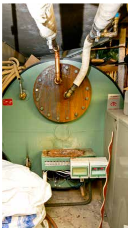
▲ GAMMEL: Varmtvannsbereider med tradisjonelle elektrokolber inne i seg. Berederen er gammel og lite energieffektiv. Store mengder varme forsvinner fra denne og ut i rommet og videre ut av bygget. Nye og mer energieffektive beredere blir installert.
